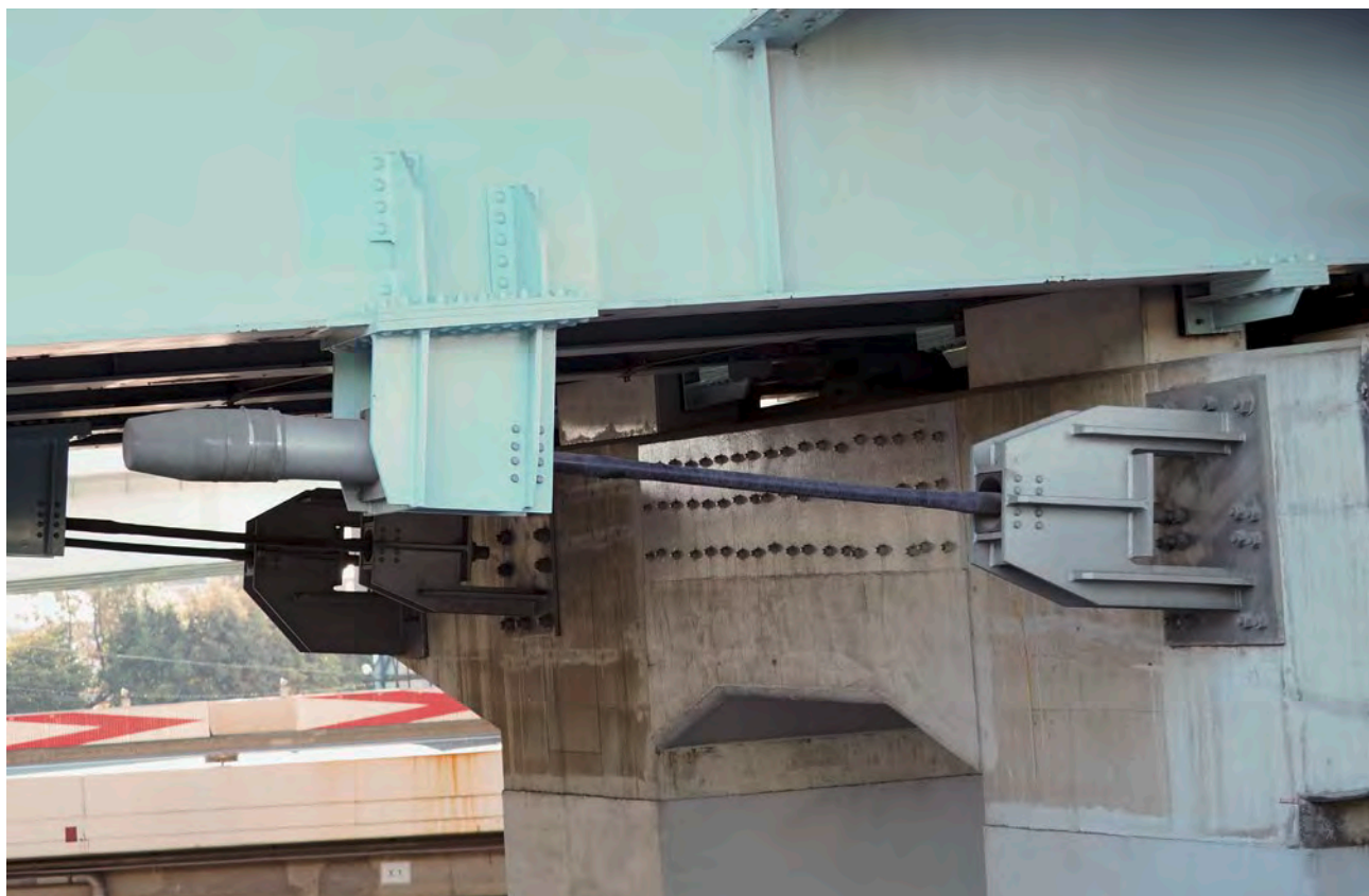
Equipamiento sísmico de un puente ferroviario.
