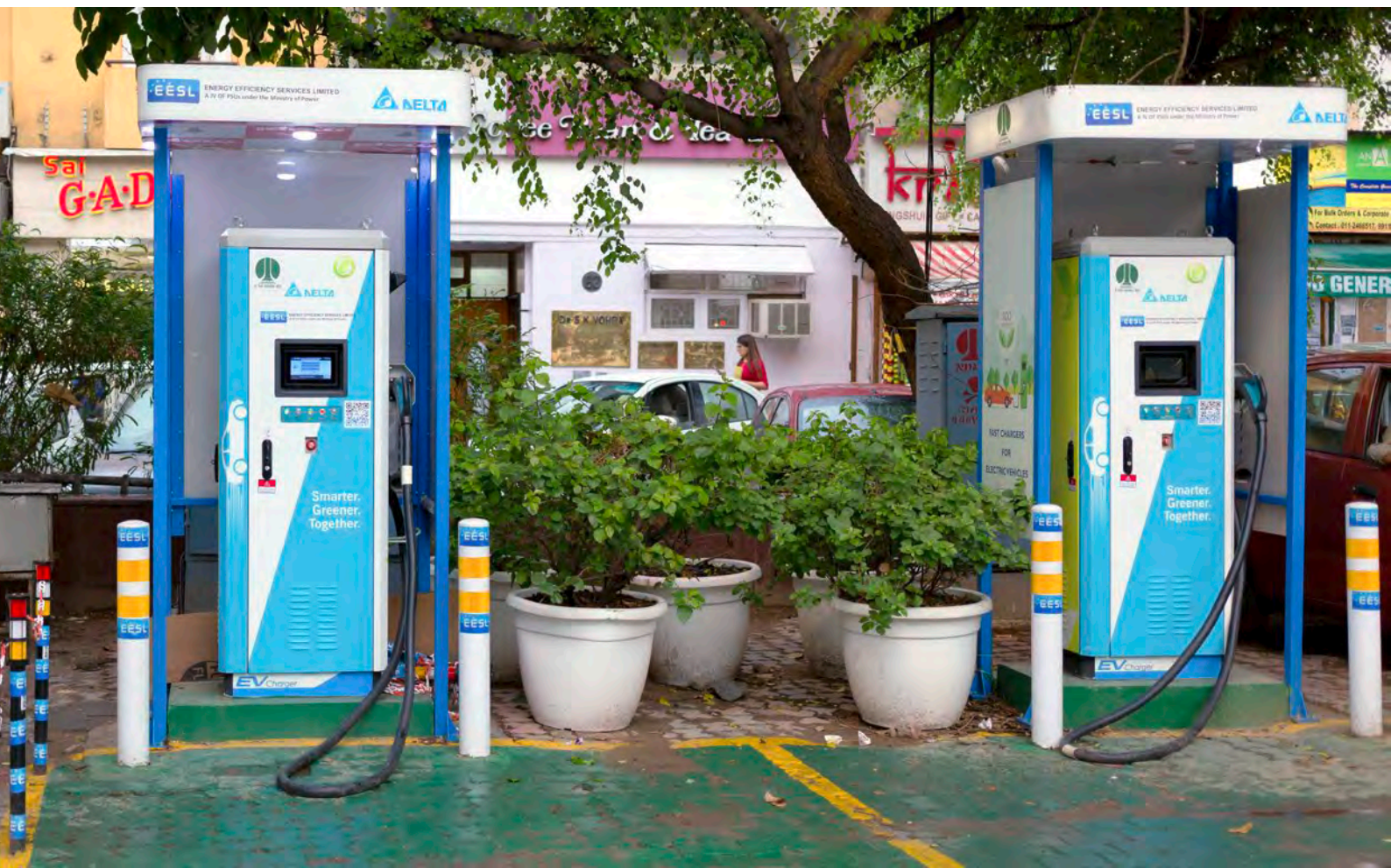
Puntos de recarga de vehículos eléctricos en un aparcamiento del mercado Khan de Nueva Delhi, India.
