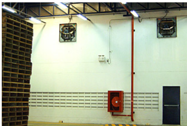
Figura 8 - Extractores en un almacén para mantener la humedad relativa
